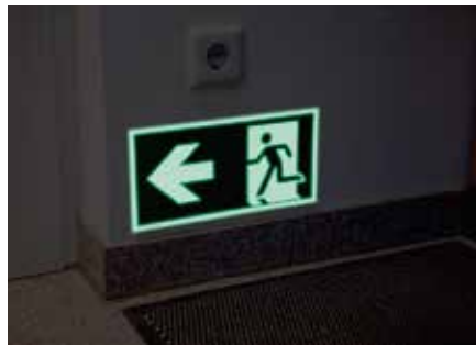
◀ Abb. 3 und 4 Im Labor Eisenach wurden die Rettungszeichen zirka 30 Zentimeter über dem Fußboden angebracht. Die Schilder leuchten im Dunkeln.
